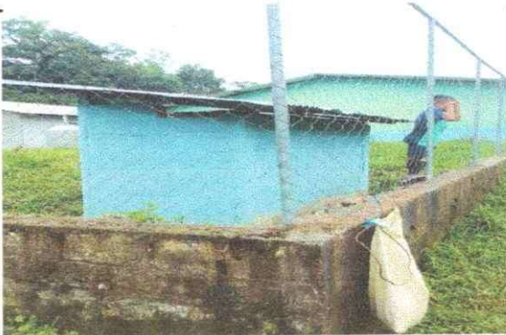
Foto 5: MURO PERIMETRAL DE BLOKS EN MAL ESTADO
