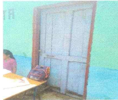
Foto 4: PUERTA PRINCIPAL EN MAL ESTADO
