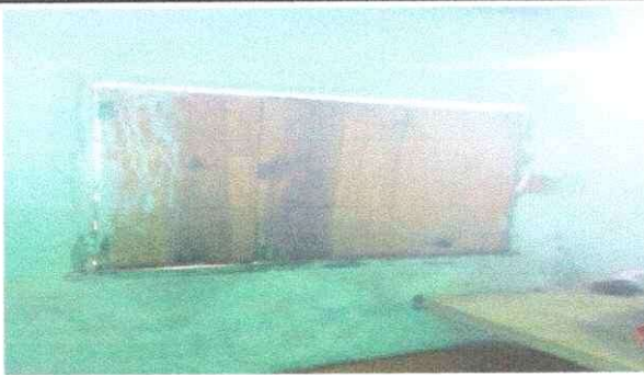
Foto 3: VENTANAS DE MADERA EN MAL ESTADO
